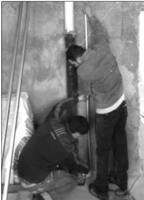
Через месяц должен завершиться капитальный ремонт хирургического отделения и операционного блока. Эти работы сейчас в ускоренном темпе ведут ООО «Пермкрайстрой» (на снимке) и ООО «Алан».
